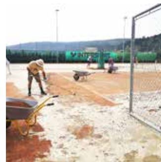
Hochwasserschaden der Tennisanlage in Leitersdorf im Jahr 2018
